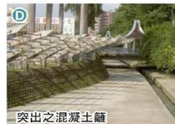
突出之混凝土牆
